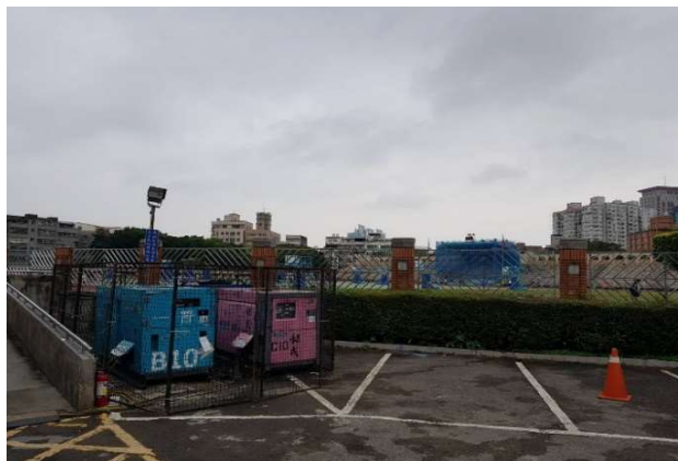
發電機租借：於場外，停車場旁
